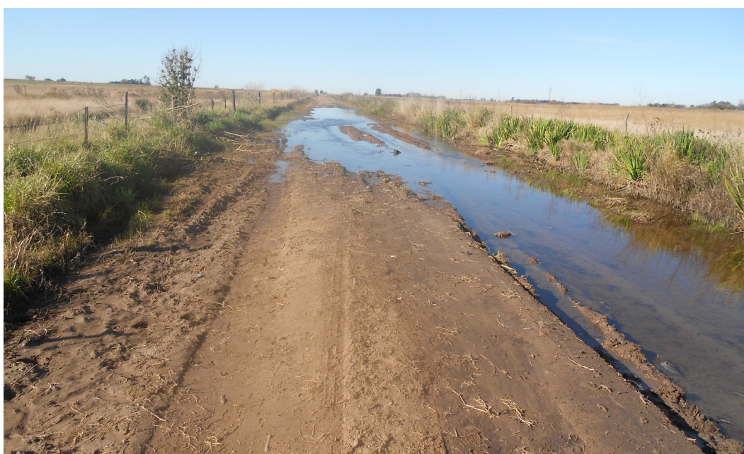
Figura 53: Anegamiento parcial de un camino rural por mala conformación y perfilado, no hay caída desde la calzada hasta las cunetas
